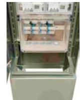
Espacio para conexiones
